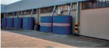
利用工厂屋顶集水（YKK南非公司）
